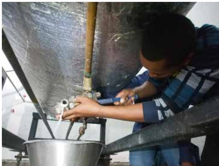
Abb. 8: Ein Techniker beim Entfernen des Kondensatableiters, der sich als fehlerhaft erwies (04.12.2019).
